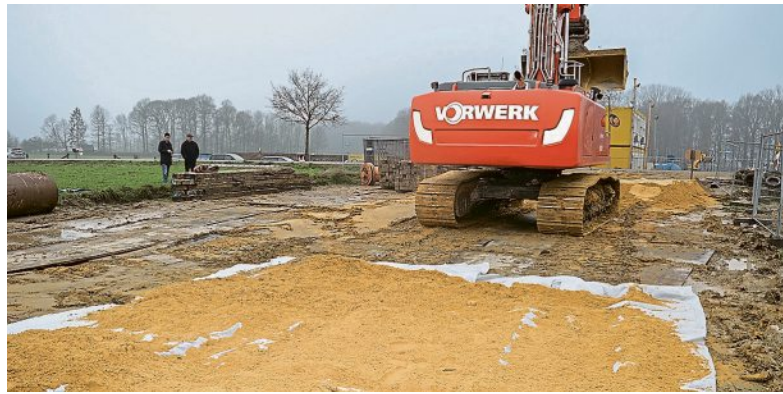
Auf der Baustellenstraße neben dem Rohrleitungsgraben dürfen die Bagger bei jedem Wetter fahren, sagt Projektleiter Kissing.
